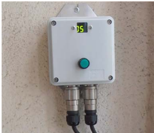
SISTEMA DE CONTROL DE LLAMADAS DE PLANTAS
